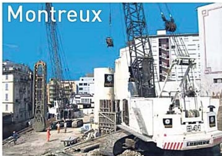
Actuellement, d'impressionnantes machines de chantier s'activent pour implanter les palissades en pieux qui soutiendront un parking sous-terrain de quatre niveaux. DR
