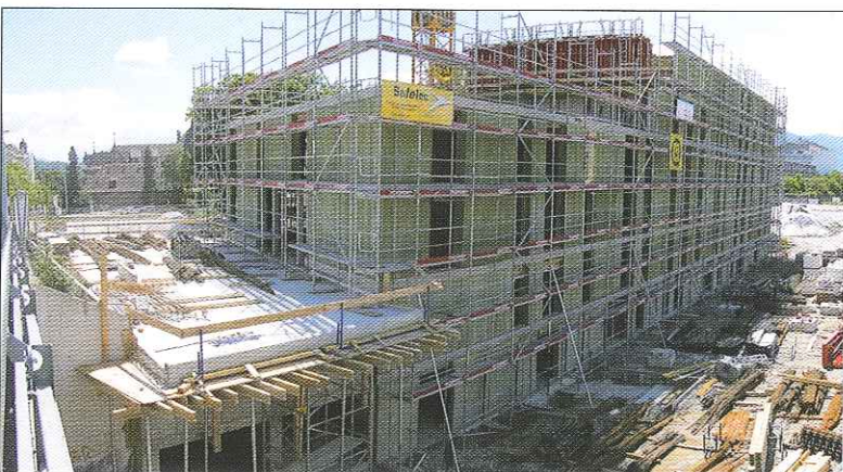
Fenêtres étages: cadres bois-métal en bois de sapin abouté et aluminium éloxé anthracite. Ouvrant en partie supérieure, allège vitrée fixe, vitrages isolants k=1.0 \text{ W/m}^2\text{K} , R_w=32 \text{ dB} . Fenêtres balcons idem.
