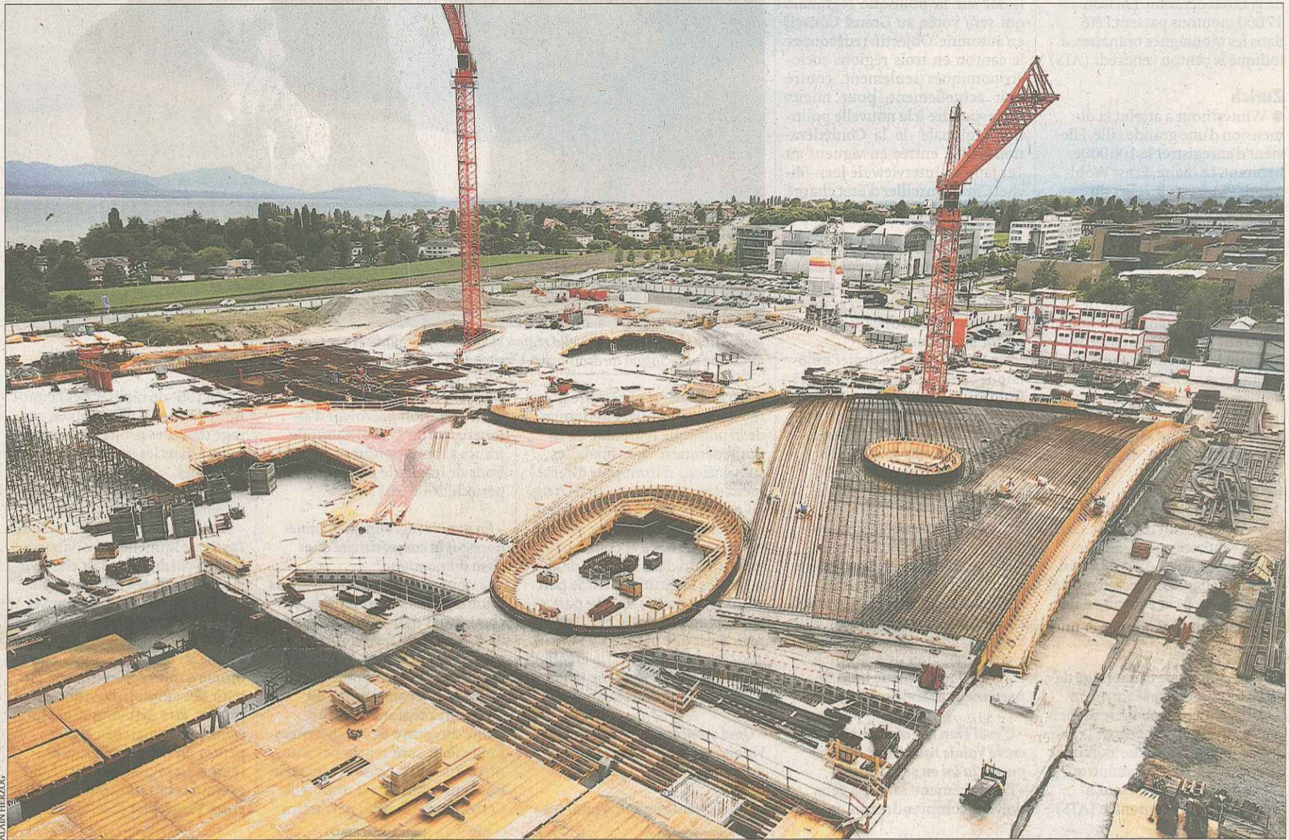
Chantier du Rolex Learning Center. L'ouvrage exprime en premier lieu une vision du monde. Partie prenante d'une réalité nouvelle, il contribue à la produire. LAUSANNE, MAI 2008
